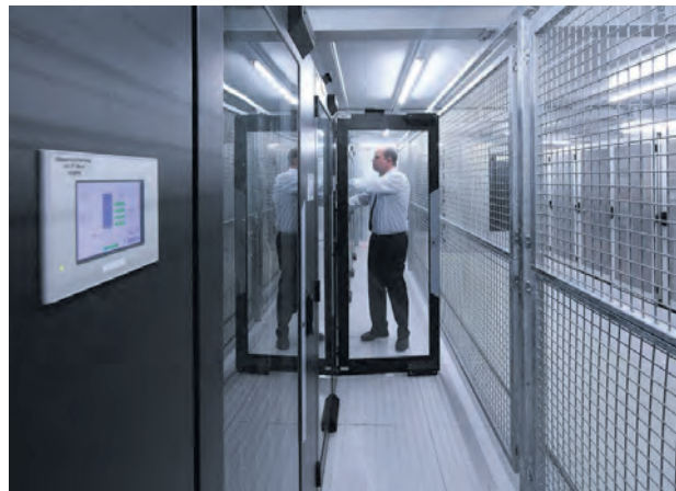
Einblick ins Rechenzentrum in Schaan – abgesicherter Bereich innerhalb des Rechenzentrums
